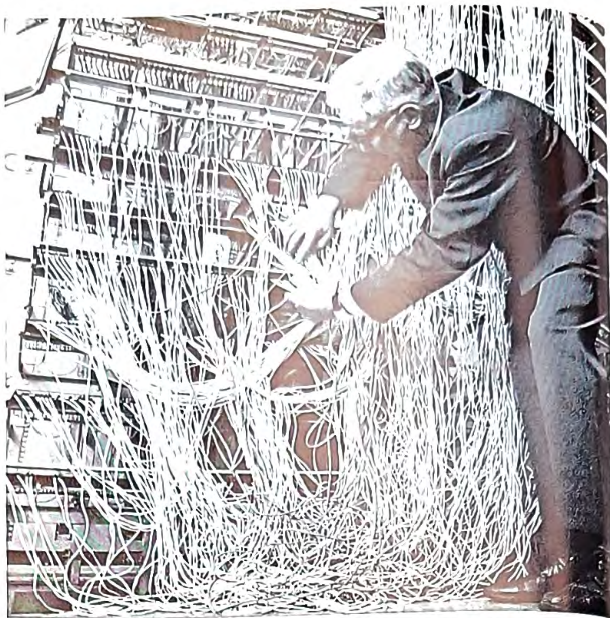
Så här kan förbikopplingssnörerna se ut i en korskoppling strax före en automatisering. Sorsele automatstation 1971.
